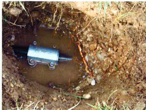
Geplatztes Bewässerungsrohr Platz 4
